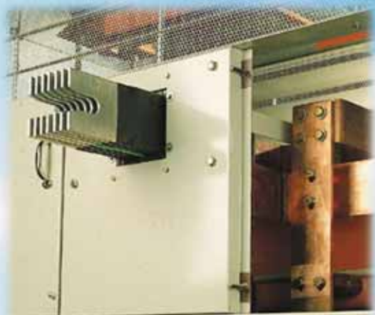
Шинный вывод низкого напряжения
